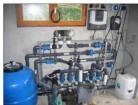
Exemple de local technique de piscine
